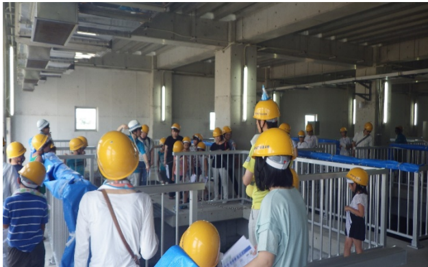
くずりゅうがわじょうか みずじょうどう 九頭竜川浄化センター 水処理棟
