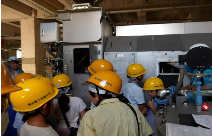
・汚泥処理棟の見学
