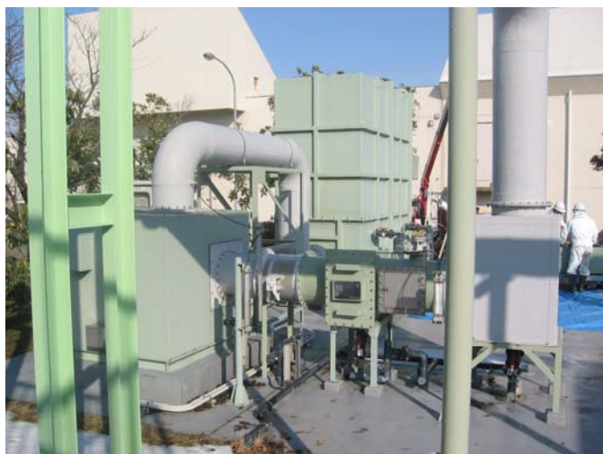
写真1 分配槽脱臭設備
