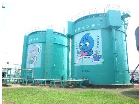
消化ガスタンク
