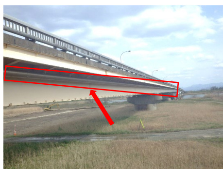
三国大橋の添架管
