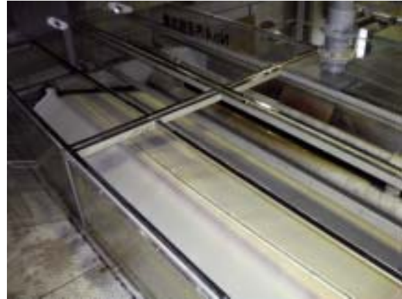
写真 2 No.4 脱水機（「ろ布」交換後）
