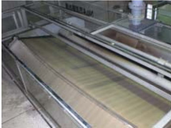
写真 1 No.4 脱水機（「ろ布」交換前）
