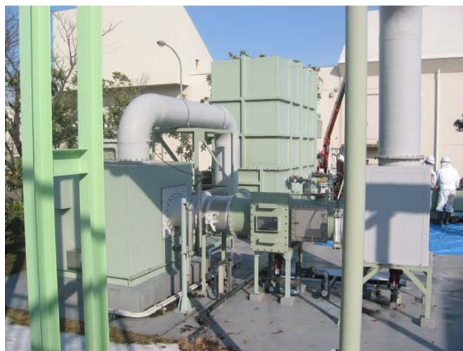
写真2 分配槽脱臭設備
